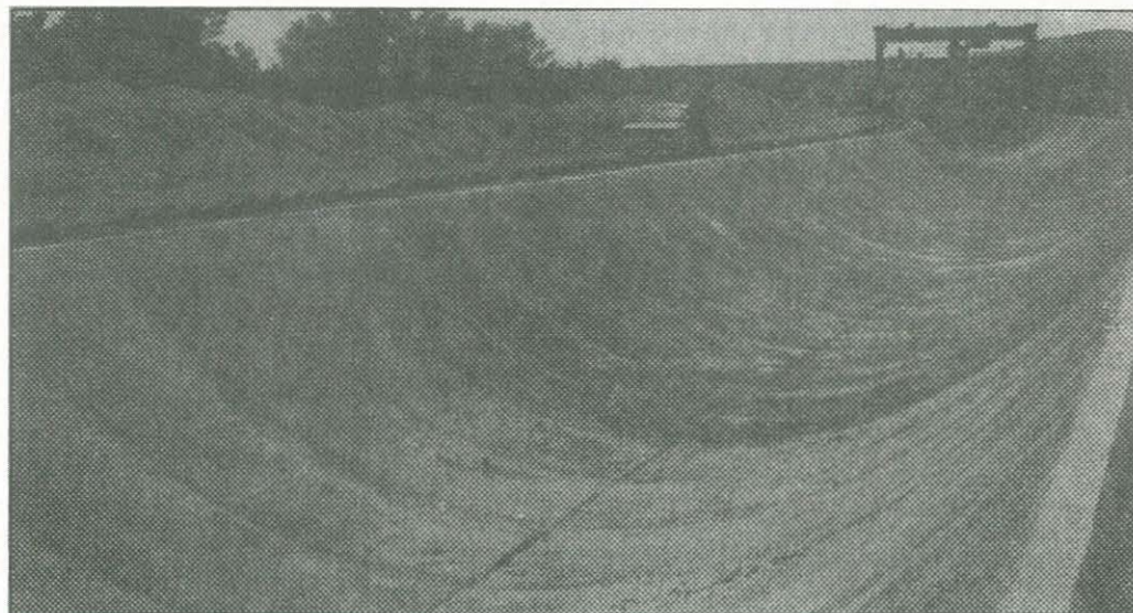
Aspecto de un tramo del canal construido y no utilizado
